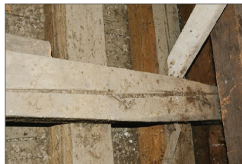
Foto 4. Fisuri, putrezire, atac insecte xilofage grinzi S, zona deasupra pronaosului.
