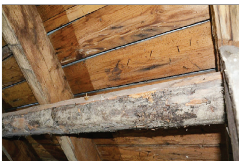
Foto 5. Atac insecte xilofage căpriori și grindă, fragilizări, putrezire așterială zona de nord, deasupra altarului.
