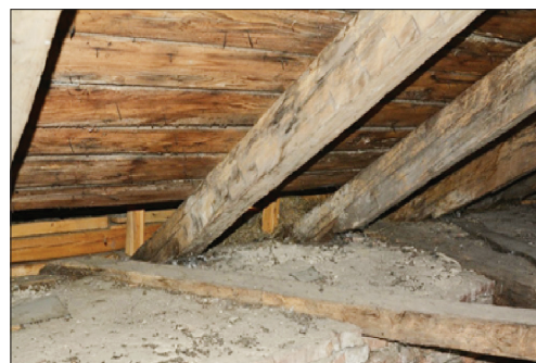
Foto 6. Degradări datorate umidității pluviale la așterială și căpriori zona de sud-vest.
